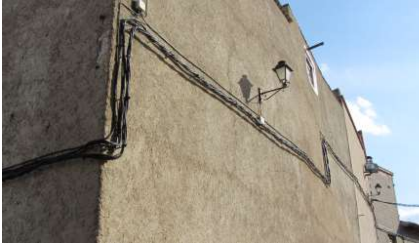
Imagen 2. Cableado en una calle de La Fresneda, Teruel (Foto: MAP)
