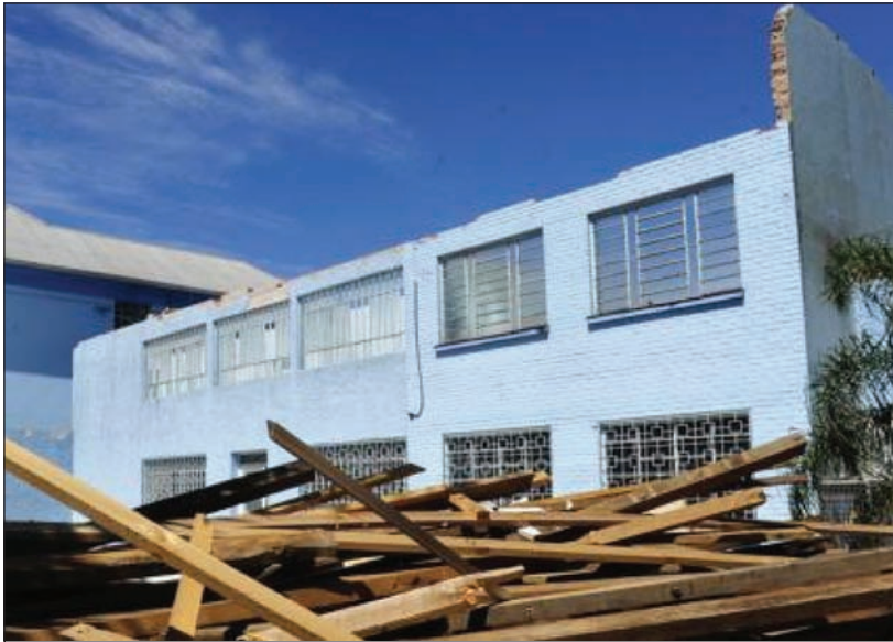
Figura 17 – Prédio danificado pelo mau tempo.
